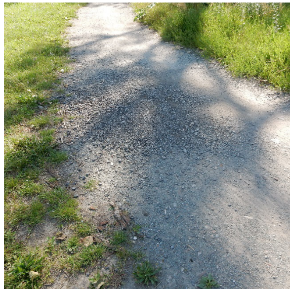
Bild zeigt loses Material im südlichen Bereich.
